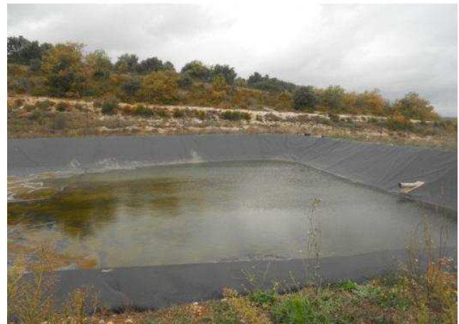
Figure 23 : Bassin de rétention des eaux pluviales
