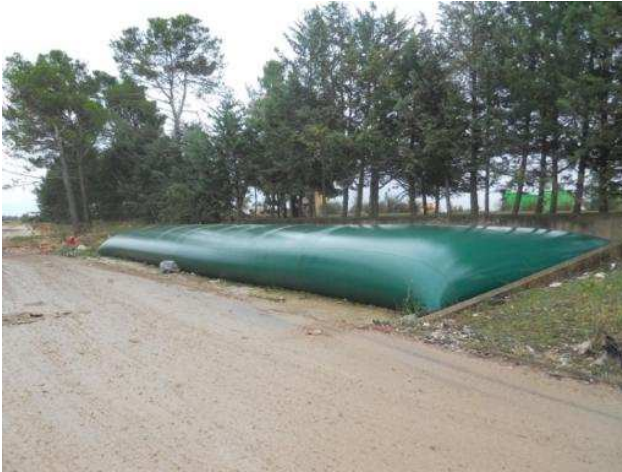
Figure 24 : Réserve d'eau de 200 m 3 pour la défense incendie
