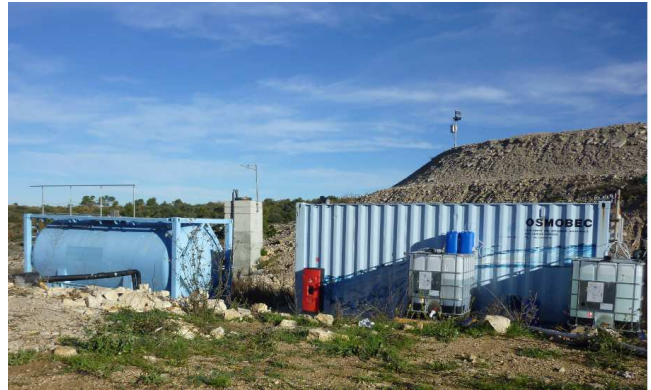
Figure 25 : Unité de traitement par osmose inverse des lixiviats
