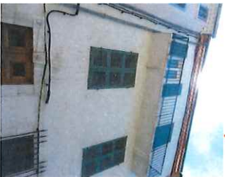
Ajout balcon sur façade et réseaux filants
