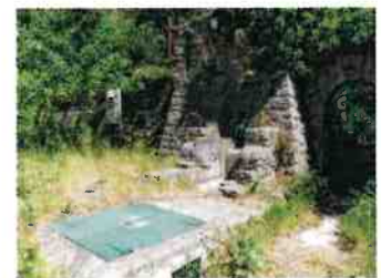
Regard de répartition extérieur
