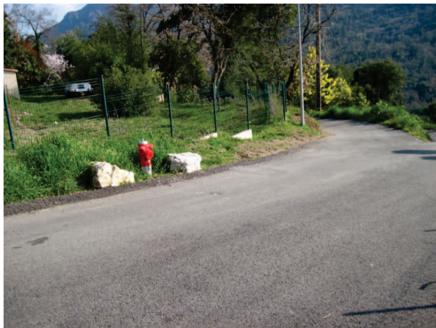
Poteau incendie installé sur le chemin de La Poterie, quartier de la Colle d'en Bermond
