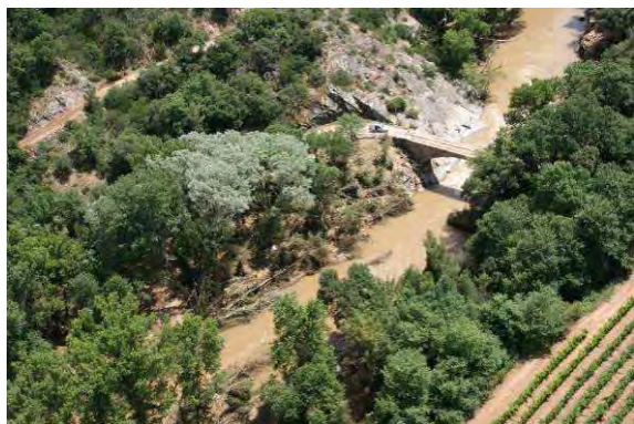
Photos 10 : Pont de la Tournavelle –Gorges de l'Argens en aval des Arcs – Post crue
