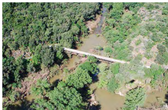
Photos 53 : Pont sur l'Aille à la confluence avec l'Argens - vue post crue
