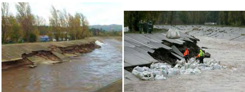
Désordres sur la digue rive droite du Reyran suite à la crue de 2011
