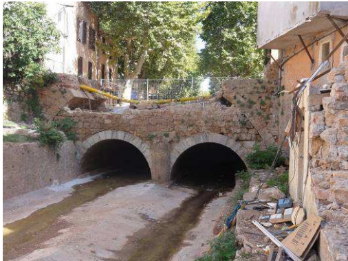
Photos 38 : Entrée actuelle et vestige de l'ancien pont, détruit lors de la crue – Le Réal aux Arcs
