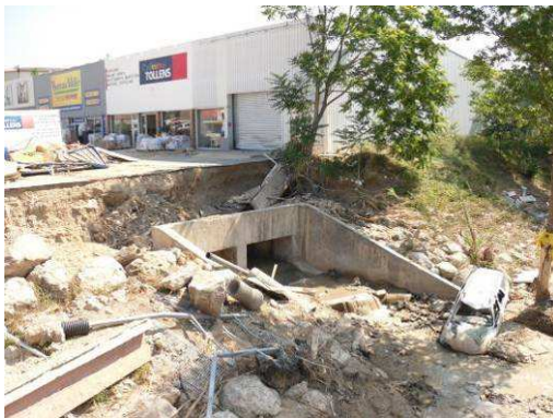
Photos 84 : Retour des eaux à la Nartuby au droit de la voie Pompidou -Post Crue
