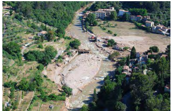
Photos 67 : La Nartuby à Rebouillon – Post Crue
