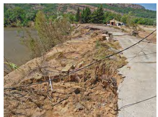
Photos 25 : L'Argens à Roquebrune Dégradation de la chaussée à l'amont du lac de l'Aréna - Post crue
