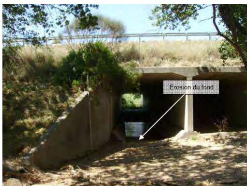
Photos 24 : Passage inferieur sous l'A8 à Roquebrune - trace d'érosion et de mises en vitesses - Source EGIS eau
