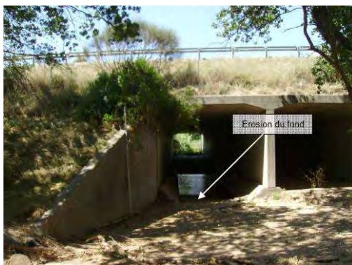
Photos 24 : Passage inférieur sous l'A8 à Roquebrune - trace d'érosion et de mises en vitesses - Source EGIS eau
