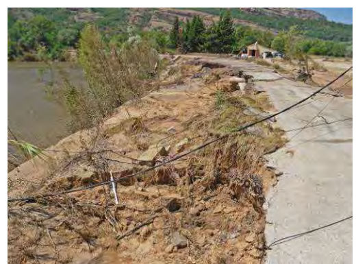
Photos 25 : L'Argens à Roquebrune Dégradation de la chaussée à l'amont du lac de l'Aréna - Post crue
