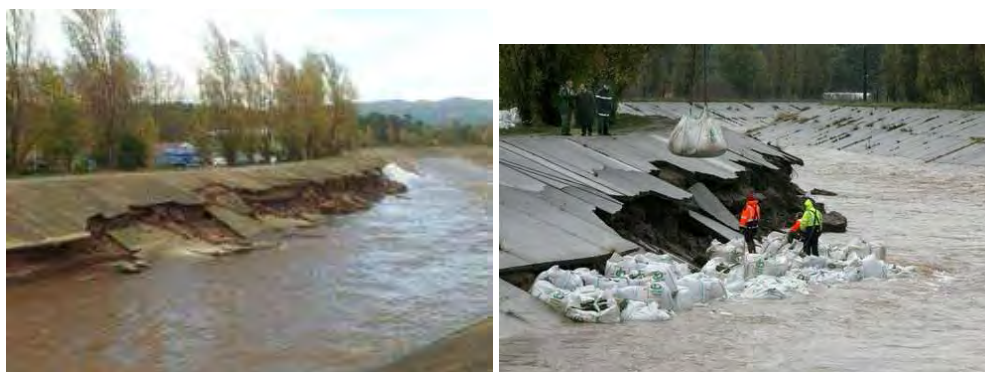
Désordres sur la digue rive droite du Reyran suite à la crue de 2011
