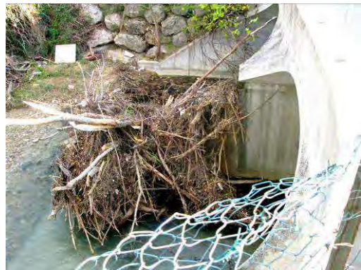
Photos 108 : Accès Carrefour Trans en Provence – 2 arches circulaires accumulant les embâcles
