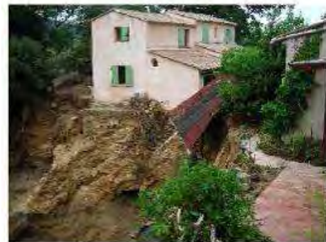
Photos 122 : Au droit de « entre deux Eaux » retour des eaux débordées dans la Nartuby
