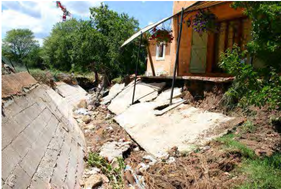
Photos 4 : Le « Vallon » de Vidauban (versant de la colline de Garduère) - Mur de clôture le long du vallon effondré
