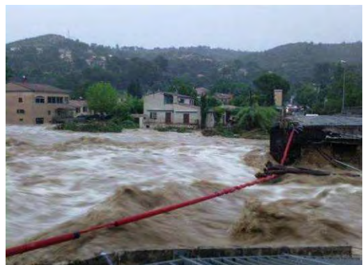
Photos 35 : La Florièye à Taradeau : Pont de la RD 10 emporté
