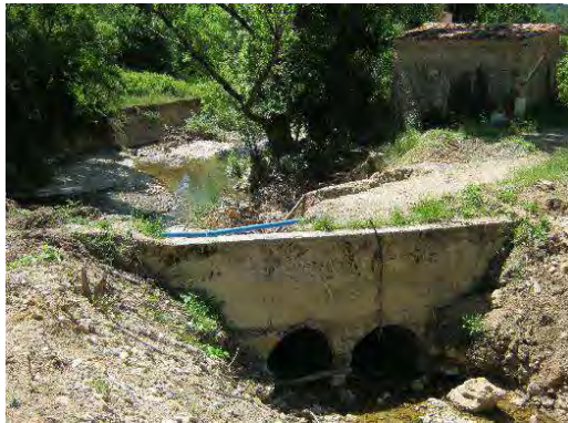
Photos 58 : La Nartuby à la confluence avec le Vallon de Bivosque – Post crue
