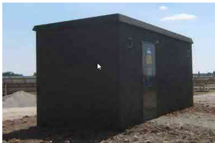
Exemple de poste transformateur
