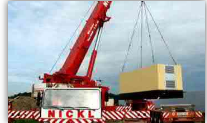
Exemple d'acheminement d'un poste de livraison préfabriqué
