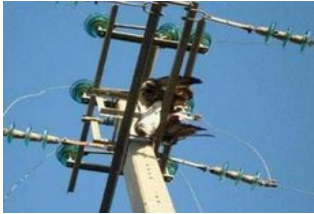
Illustration 20: Aigle de Bonelli électrocuté sur un pylône électrique -type interrupteur aérien IACM - (C. Audic 2008)
