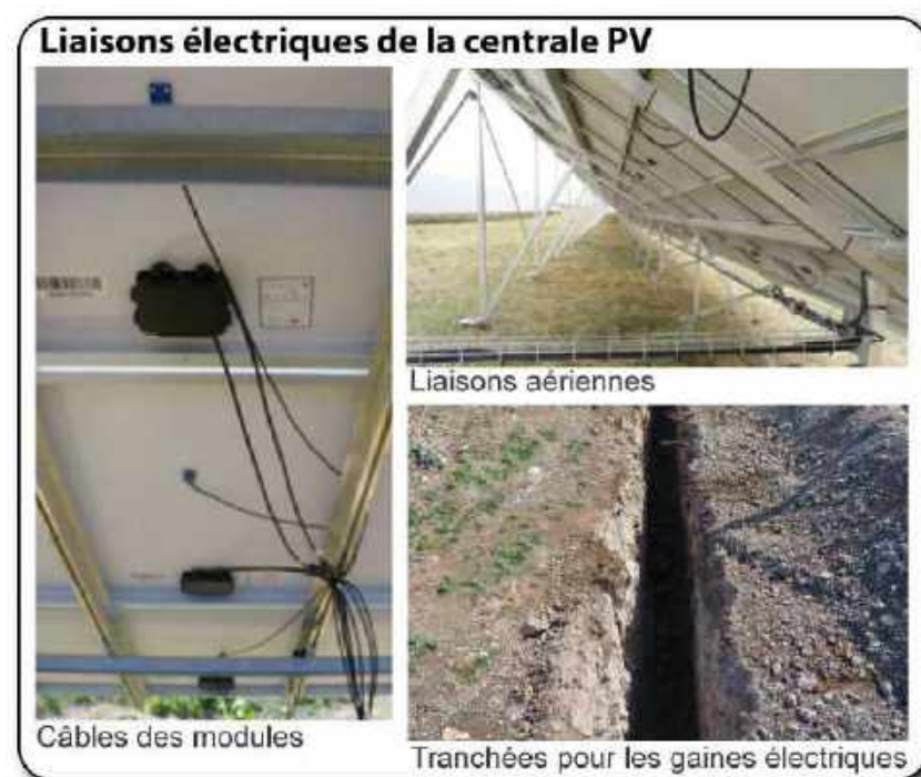
Photographie 47 : Liaisons électriques
