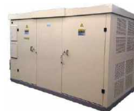
Photographie 46 : Exemple de local technique
