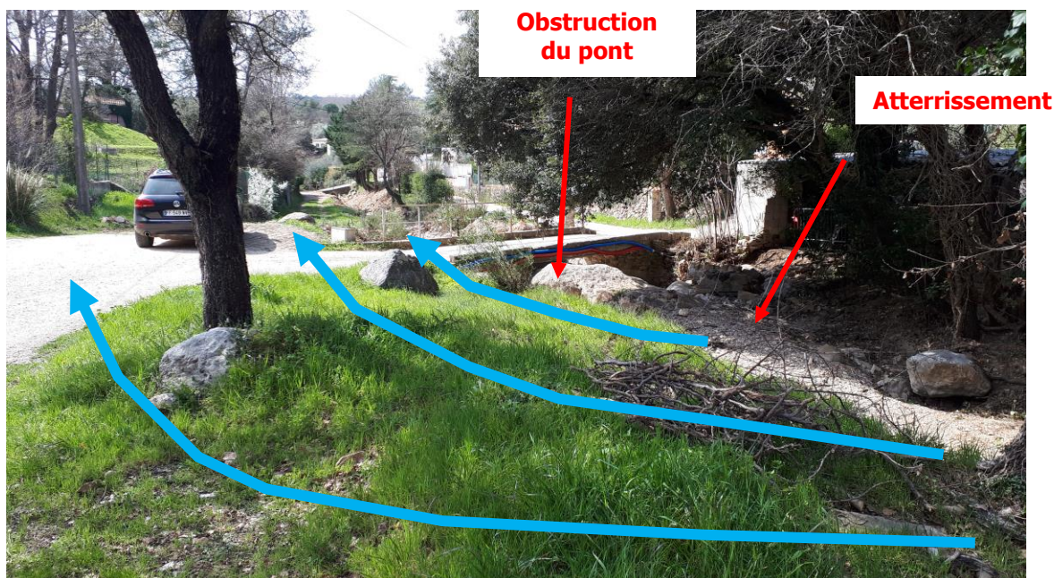
Secteur 1 - Franchissement, non axé dont une arche est totalement obstruée par un bloc (flèches bleues = débordement)
