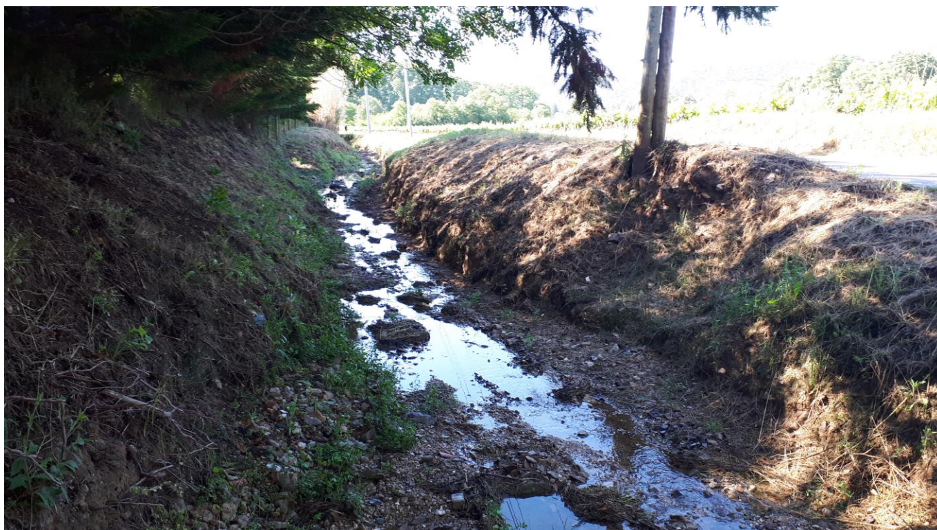
Effondrement de la berge rive droite
