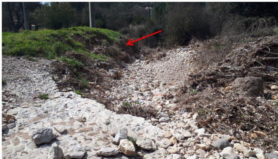
Surcreusement à l'aval de l'ouvrage et érosion rive la berge gauche
