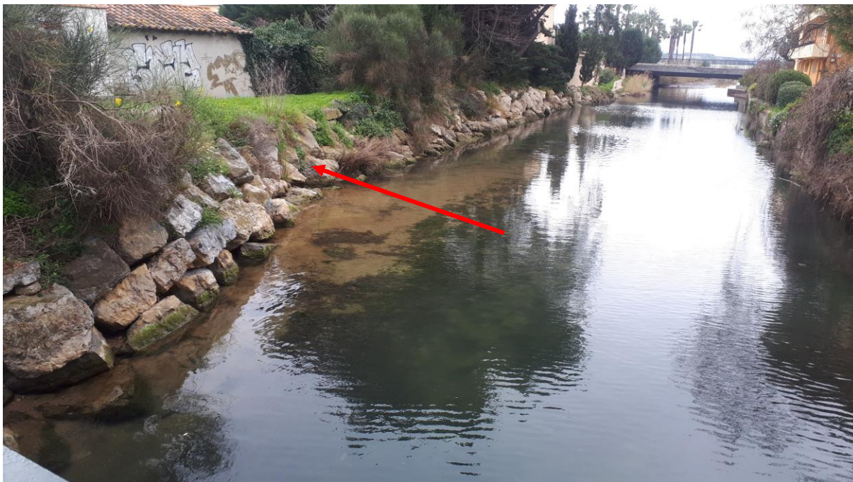
2. Enrochements affaissés à reprendre aval immédiat rive gauche de la passerelle
