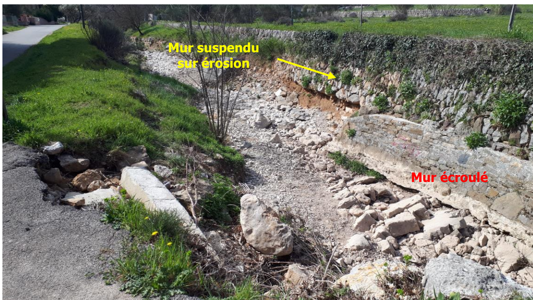
Secteur 2 -Erosion de la berge affectant à gauche le chemin du Deltel, à droite un mur de propriété
