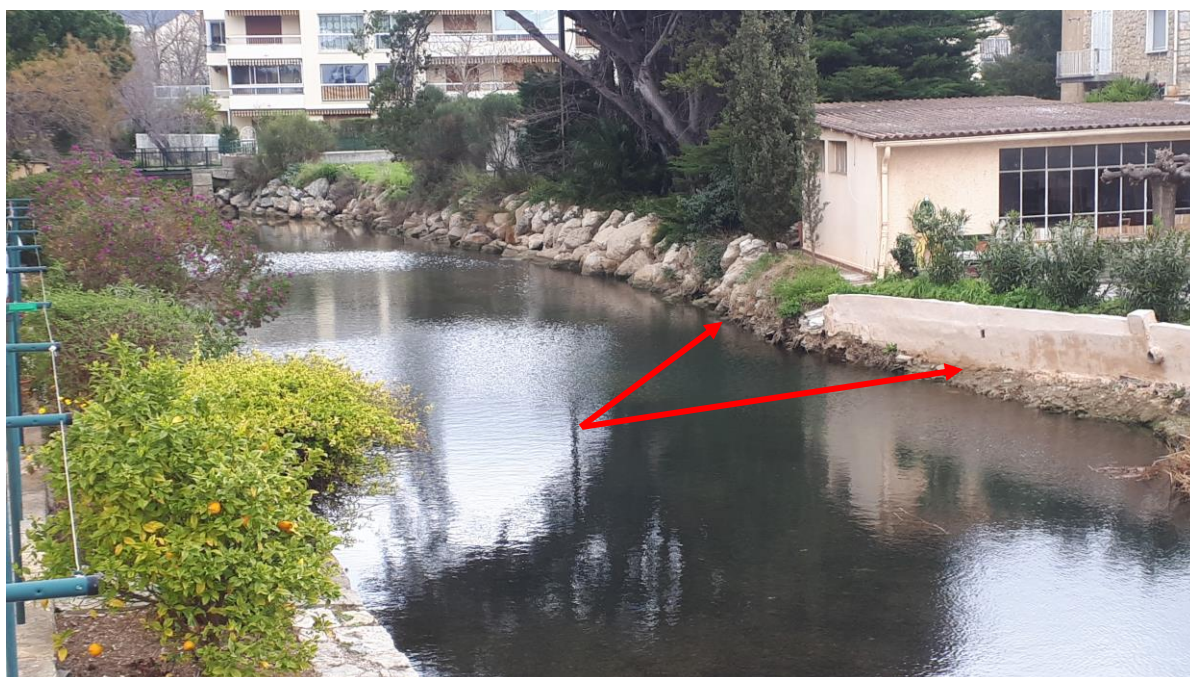
3. Mur déstabilisé e berge fragilisée
