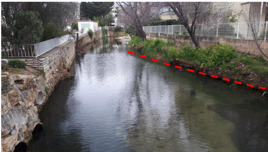
1. Berge rive gauche érodée en amont rive gauche de la passerelle (mur menacé)
