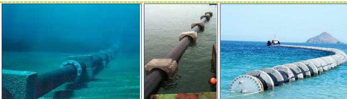
Figure 60. Exemples de conduites lestées avec des cavaliers béton
