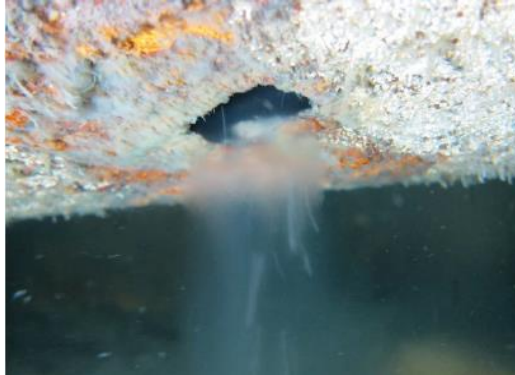
Exemple de trou dans la conduite de rejet (situé à 6 h)
