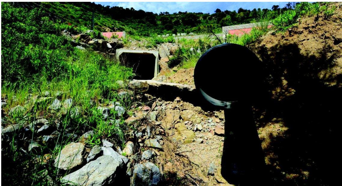
Figure 115 – Zone affouillée en sortie du cadre en avril 2015
