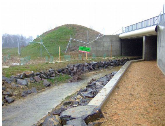
Crédit photo : Cerema Déploiement d'action de sensibilisation in-situ (panneau informatif sur la sensibilité environnementale de la zone)
