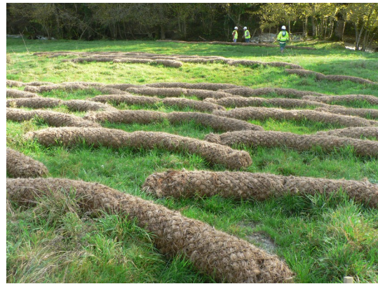
Crédit photo : Cerema Dispositif préventif de lutte contre une pollution : boudins "coco" jouant un rôle de filtre temporaire
