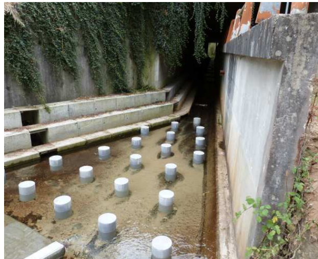
© ATLANDES - Autoroute A63 : équipement d'ouvrages hydrauliques anciens (Source : Onema)
