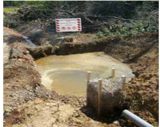
⊗ Bassin de décantation sous-dimensionné et filtre à paille non fonctionnel
