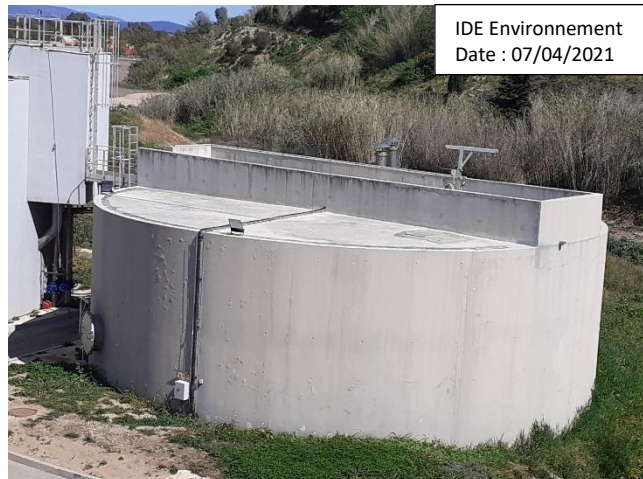
Photo 4 : Post-digesteur / Stockage des digestats
