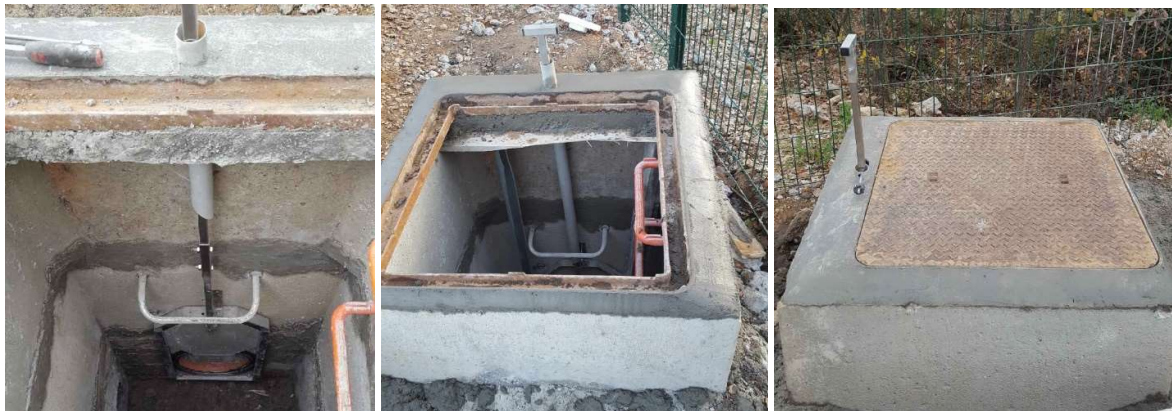
Exemple de martelière de sectionnement du réseau
