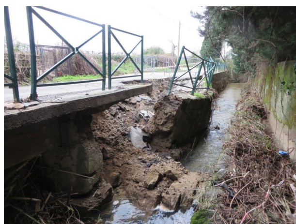
Figure 11: Prise de vue post-crue de l'effondrement de la route bordant le ruisseau de l'Emponse (Source : communauté de communes Golfe de Saint-Tropez)
