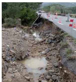
Figure 8: Affouillement de la route au niveau de la Confluence du ruisseau du Plan (source : La lettre du Plan de la Tour Octobre Novembre Décembre 2009)
