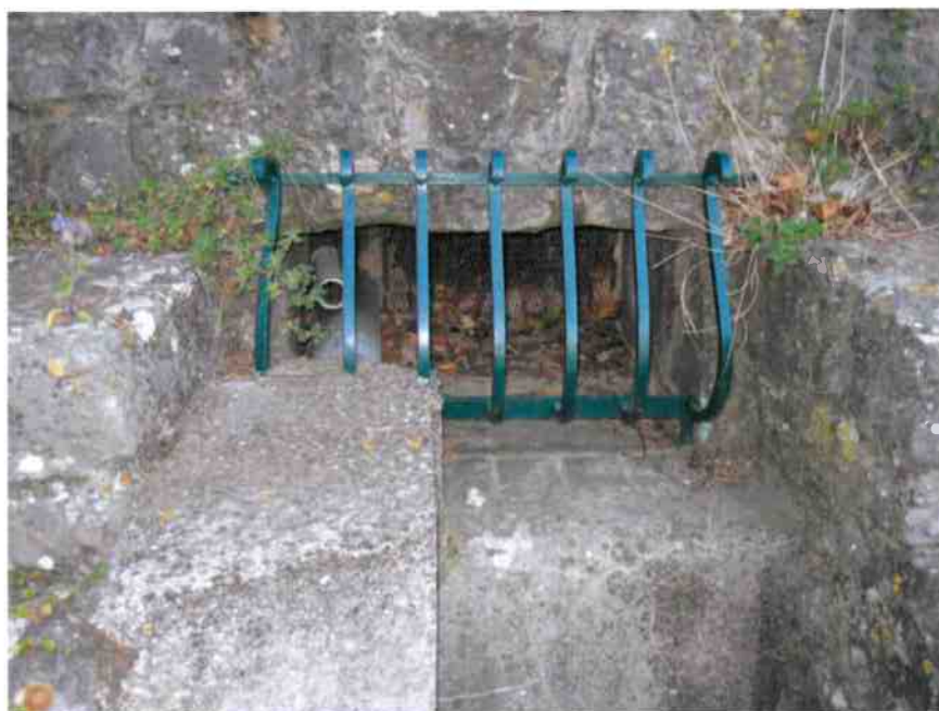
Grille à modifier et tuyau à enlever
