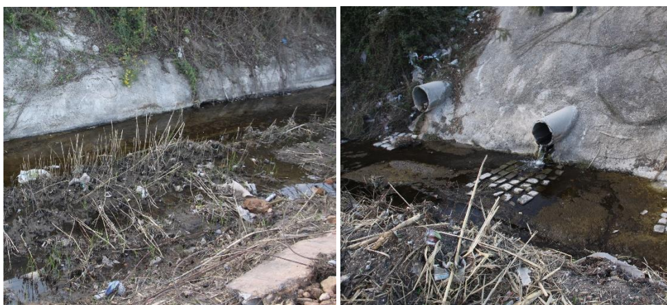
Figure 70 : Mauvais état du Vallat de Faveyrolles
