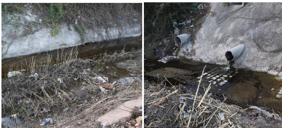
Figure 70 : Mauvais état du Vallat de Faveyrolles
