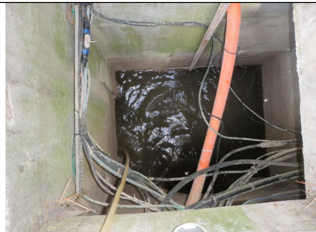
Vue du regard du rejet de lavage des filtres (installation du préleveur n°1)
