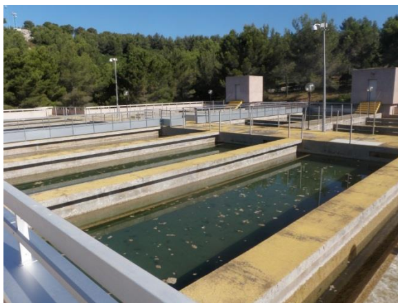
Vue des filtres à sable : étape de filtration gravitaire
