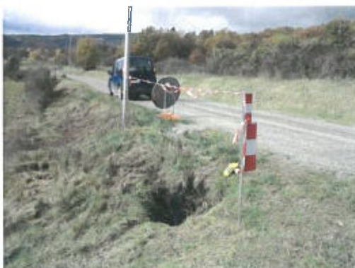
Effondrement localisé © GEODERIS
