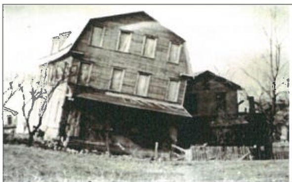
Domage sur une habitation en raison de la survenance d'un affaissement - © GEODERIS
