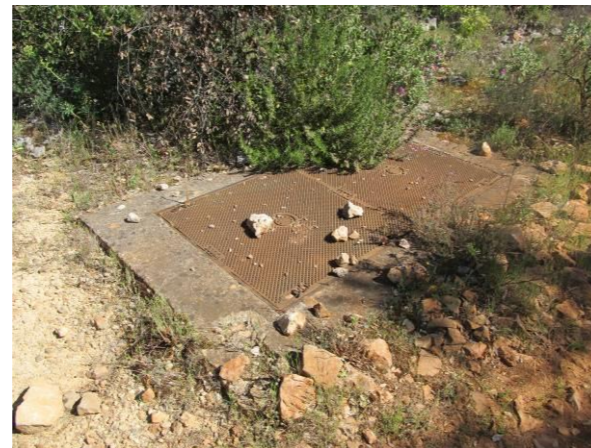
Photographie 47 : Regard France Telecom au centre de la zone d'étude immédiate
