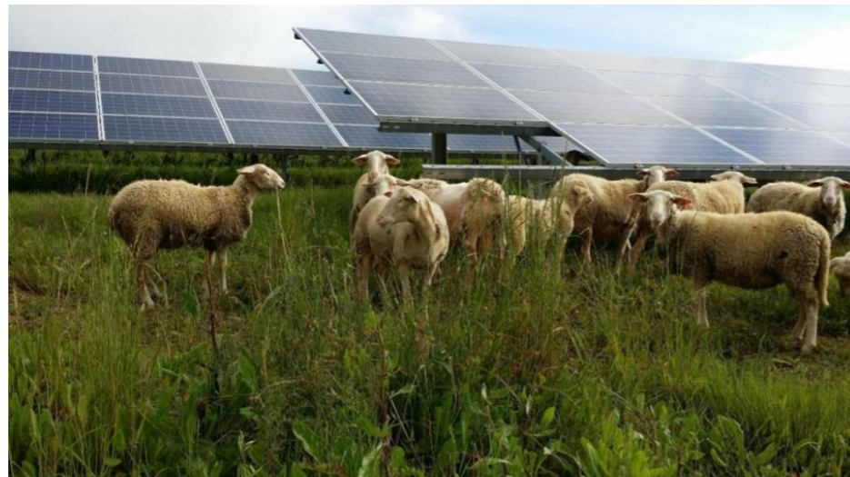
Figure 170 : Photographie moutons au sein d'une centrale PV Luxel - Source : EDF Renouvelables
