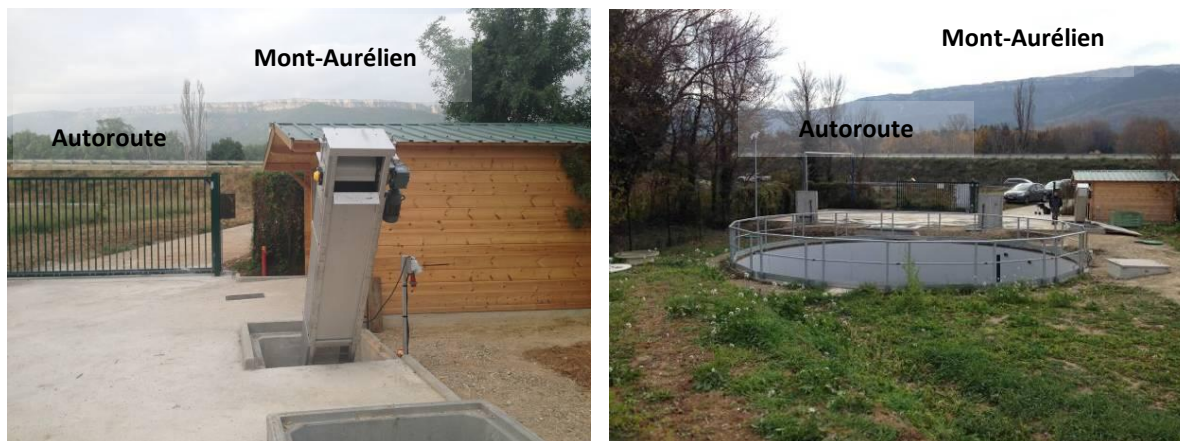
Figure 16 : Vues sur l'autoroute et le Mont-Aurélien depuis l'aire de lavage (photo SEGED)
