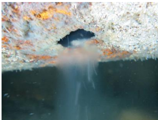
Figure 15 : Exemple de trou dans la conduite de rejet (situé à 6 h)
