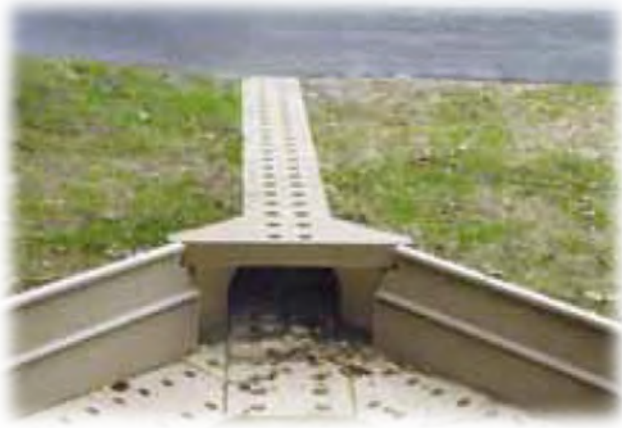
Photographie 4 : Photo d'un exemple de batrachoduc (source : ACCO crapauduc)
