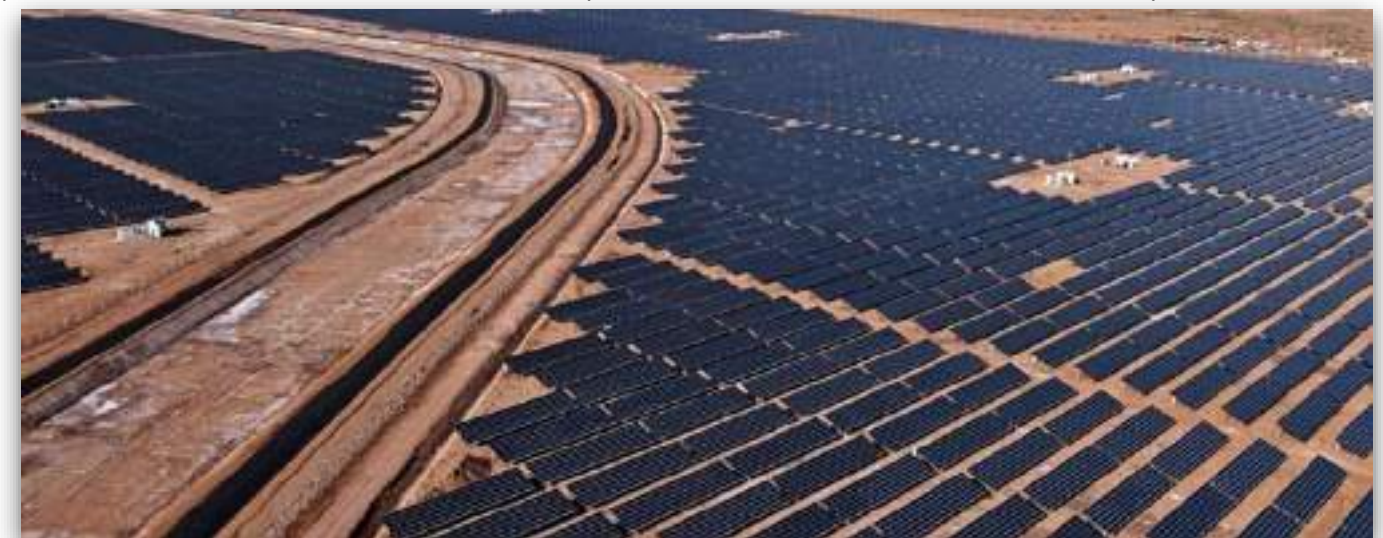
Centrale photovoltaïque au sol de Kamuthi, Inde
