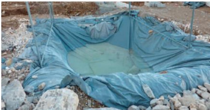
Exemples de fosses étanches de récupération des résidus de nettoyage des goulottes des toupies béton
