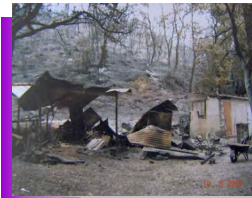
Dégâts sur une installation Extérieure/dépendances
