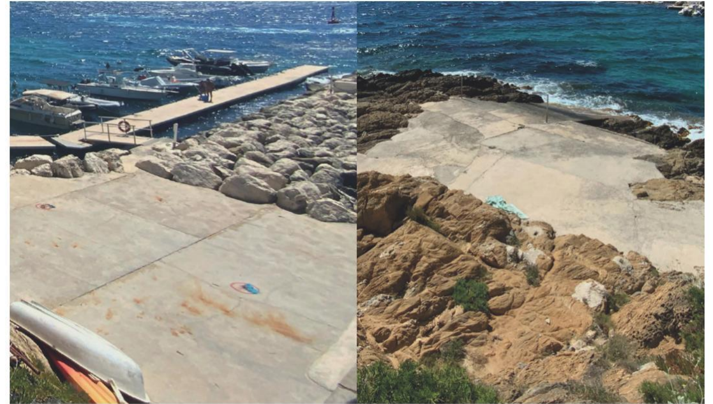
De grandes zones bétonnées en mauvais état
