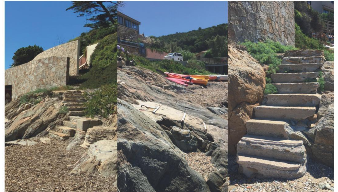
Des escaliers et rampes usés
