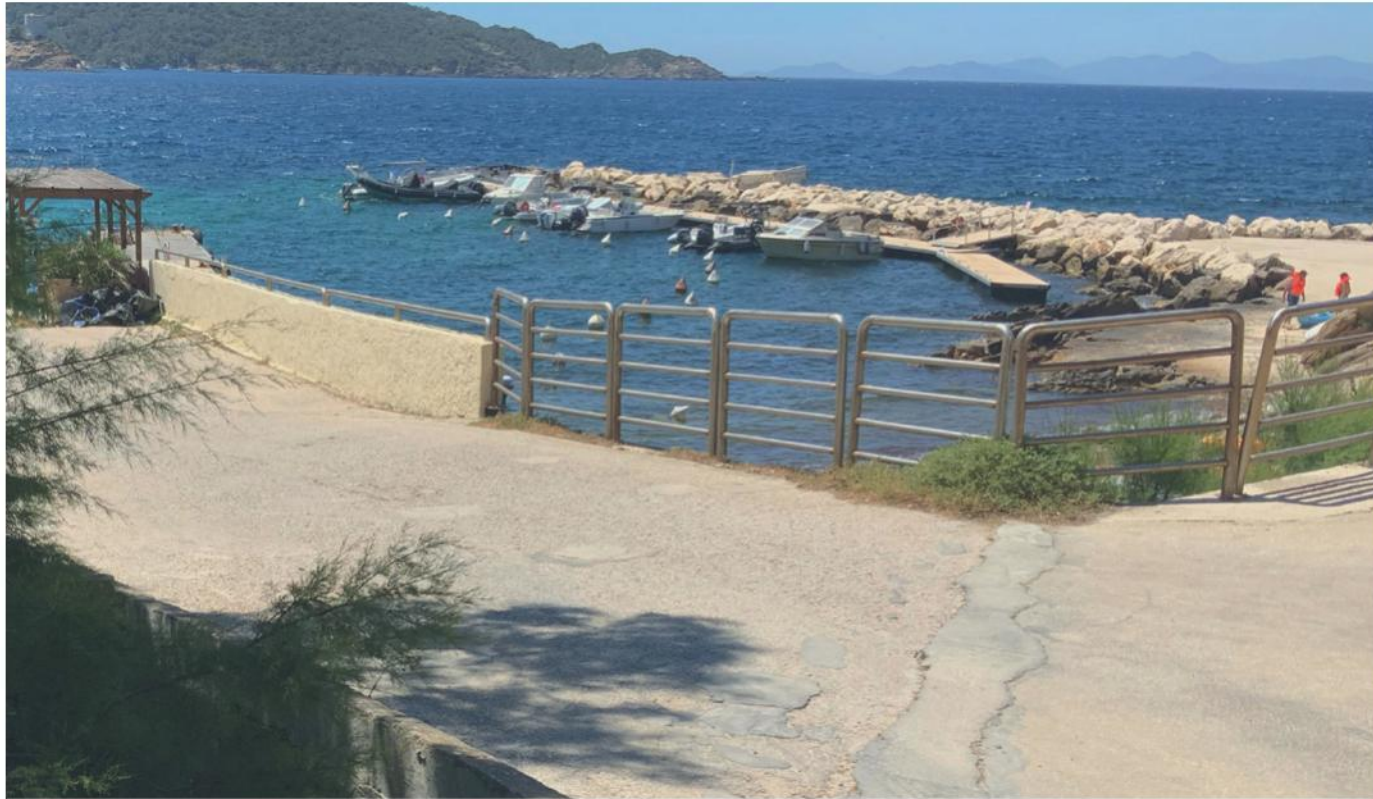
Garde-corps, parapets hétérogènes
