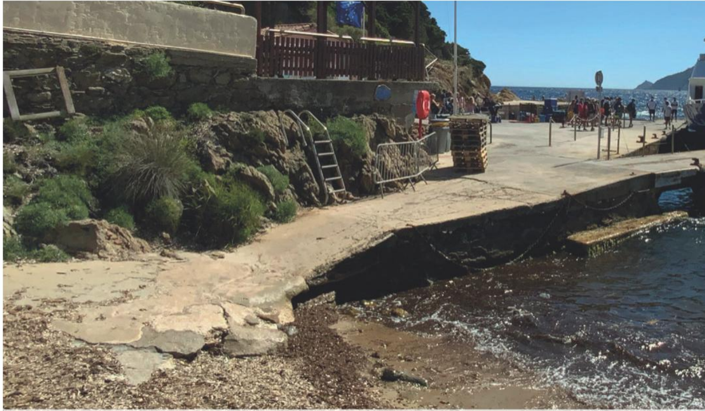
Accès à la plage dégradé et belle zone rocheuse acculée
