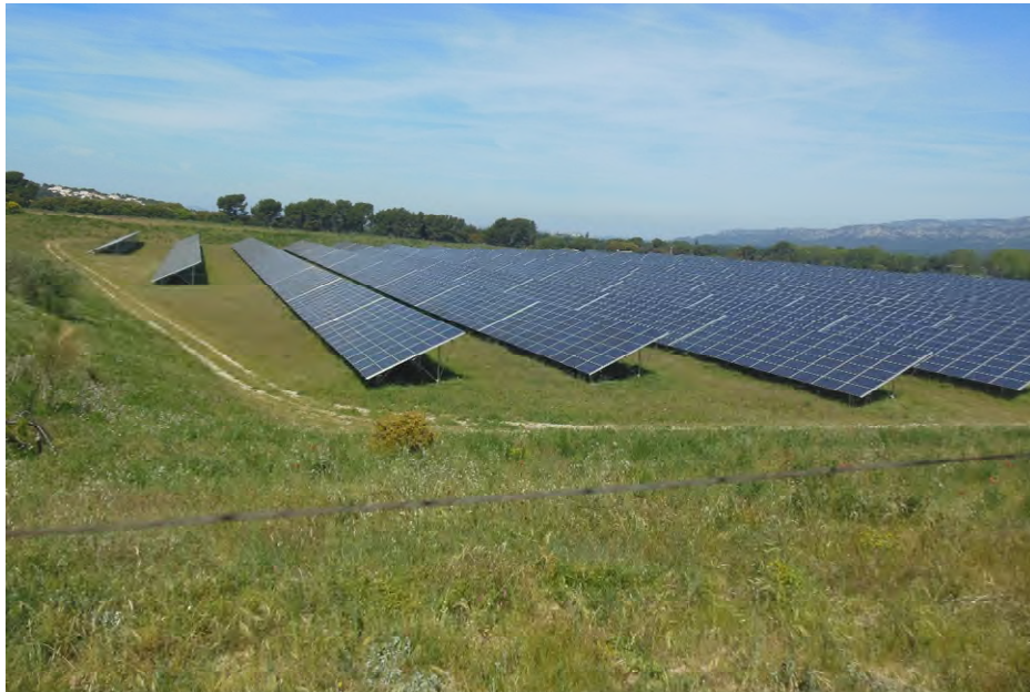
Parc solaire de Charleval (13) sur une ancienne carrière
