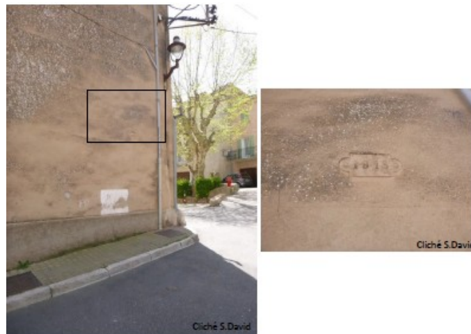
Illustration 6: Repère de crue daté de 1915, route du Luc (Géorives 2018)
