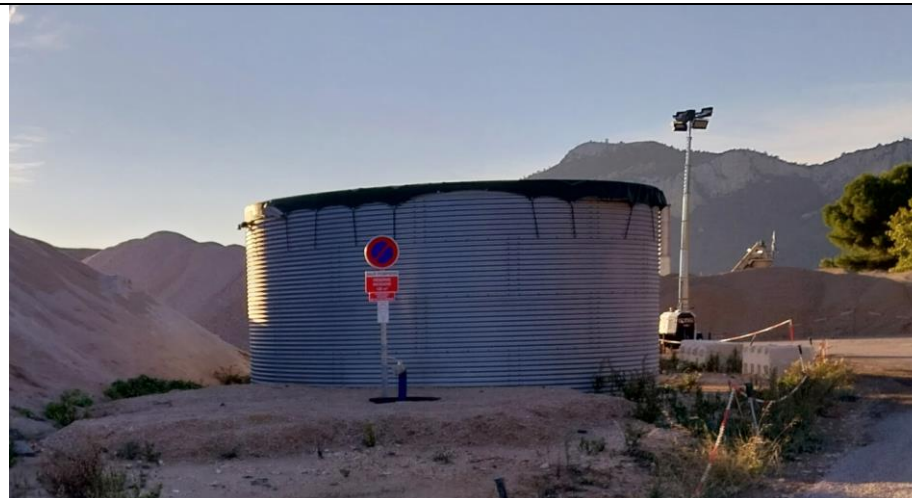
Vue 5 - Citerne DFCI 1 de 120 m 3
