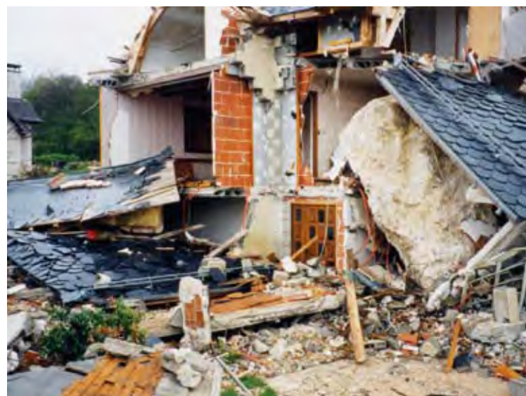
Maison sinistrée par la chute d'un bloc.
