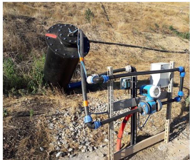
Figure 24. Puits de pompage sous bâche
