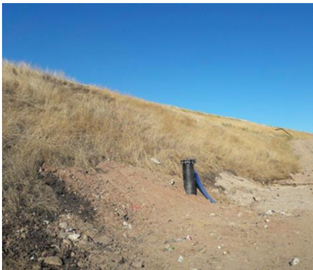
Figure 23. Puits de dégazage
