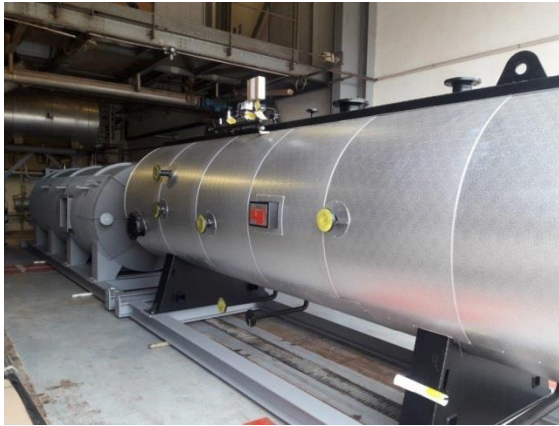
Figure 25. Photo de la chaudière
