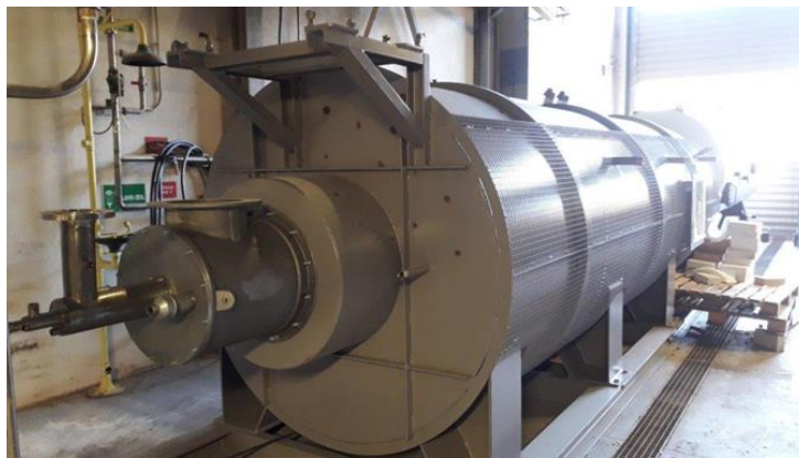
Figure 27. Photo de l'oxydeur thermique dans le prolongement de la chaudière
