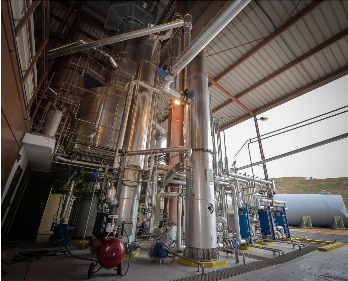
Figure 37. Photo de l'évaporateur
